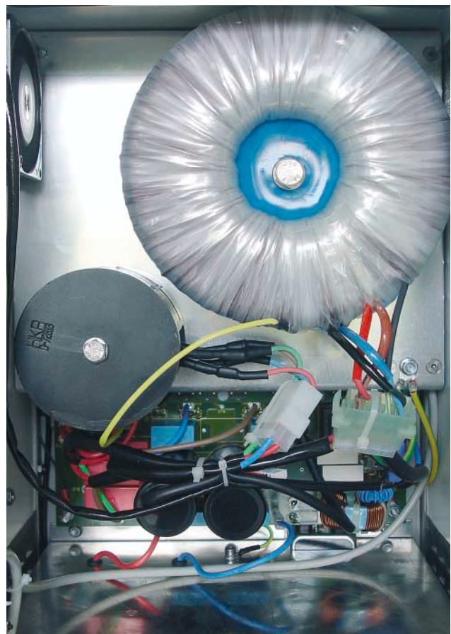
Bild 6 Innenansicht Sun Profi von Sun Power
