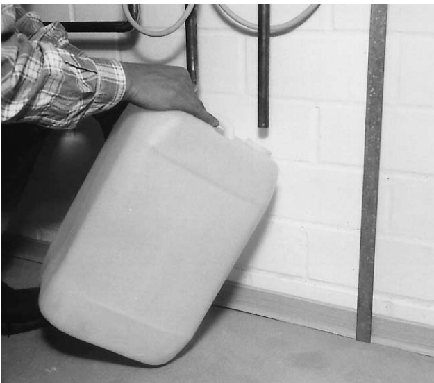
Bild 15 Abblaseleitung am Sicherheitsventil installieren und leeren DC20-Kanister zum Auffangen der Solarflüssigkeit unterstellen.
