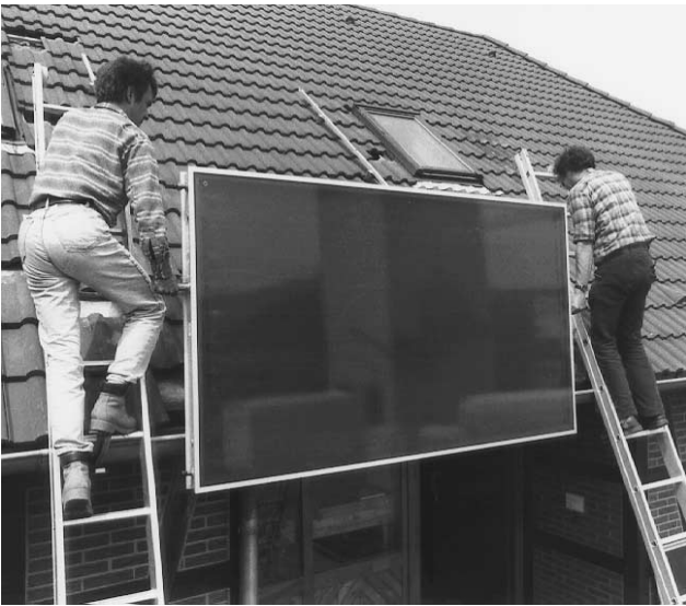
Bild 13 Bei Arbeiten auf dem Dach beachten Sie bitte der eigenen Sicherheit zuliebe unsere "Sicherheitshinweise zur Kollektormontage".
