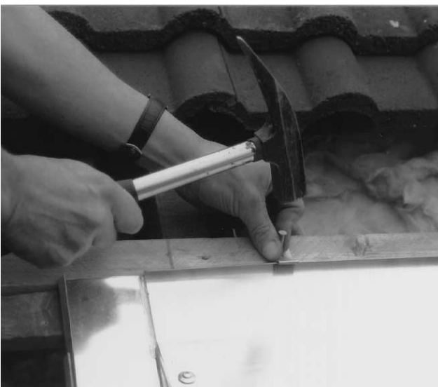
Bild 33 Obere Abschlussbleche am Rand zu den Ziegeln mit zwei Befestigungshaften pro Blech auf der Dachlatte fixieren.
