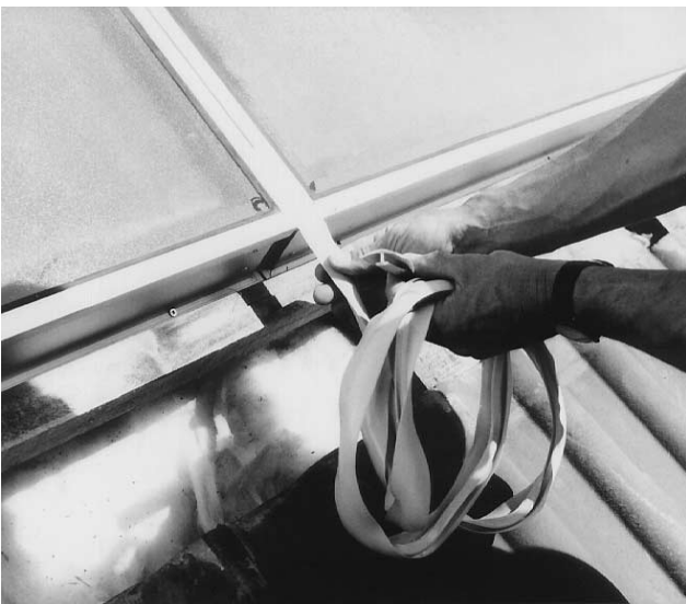
Bild 15 In die Spalte zwischen den Kollektoren Silikon-T-Profil einschieben. Abwechselnd drücken und ziehen erleichtert die Arbeit. Anschließend die Kollektoren bündig zusammenschieben.
